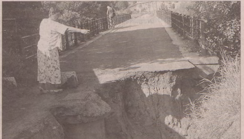
To skandal. Ile można czekać na naprawę mostu - mówią zirytowani mieszkańcy.
