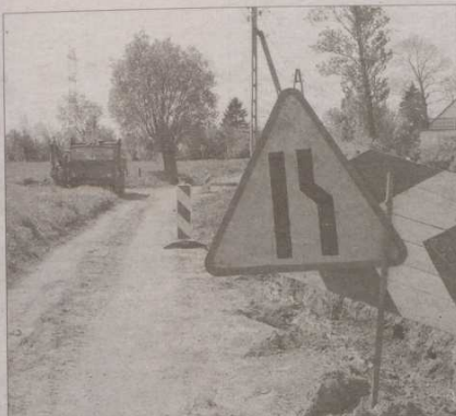
Nieopodal tej koparki na pracujących w głębokim rowie robotników runęła skarpa.
