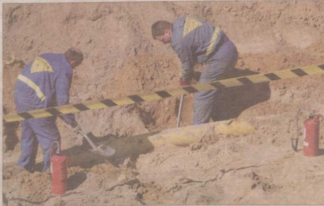
Na szczęście koparka nie wywołała iskry. Gdyby tak się stało, doszłoby do gigantycznej eksplozji. Na zdjęciu pracownicy zabezpieczający uszkodzony fragment gazociągu.
