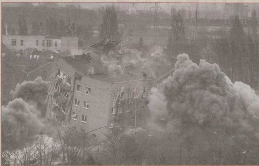
Tragedia w wieżowcu w 1995 roku wstrząsnęła całym Gdańskiem. Pirotechnicy musieli wysadzić uszkodzony budynek.
