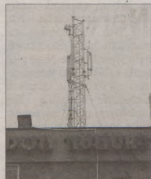
Maszt „komórkowy” na dachu Spółdzielczego Domu Kultury, przy ul. Reyntmonta.
