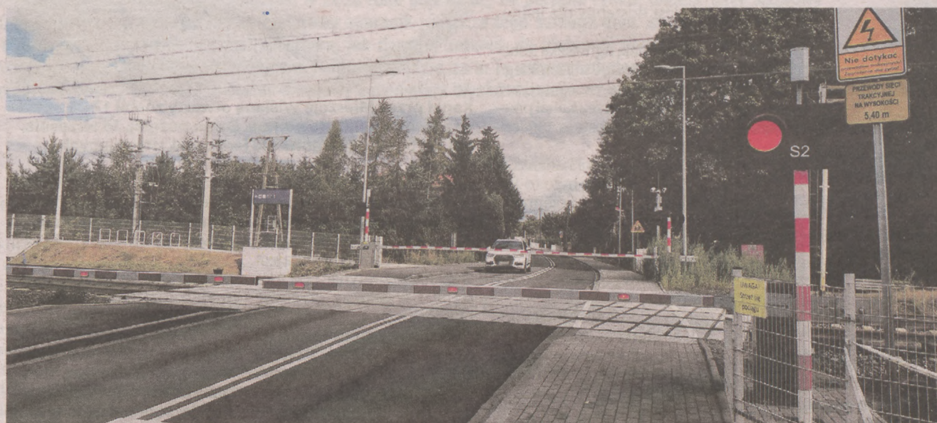
Dodatkowe zabezpieczenia na przejazdach kolejowo-drogowych zwiększyły bezpieczeństwo pasażerów kolei oraz kierowców i pieszych.
