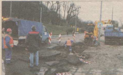
Woda z pękniętego wodociągu zniszczyła dwa fragmenty Traktu św. Wojciecha. Najpóźniej dzisiaj rano na drodze zostanie wznowiony normalny ruch.
