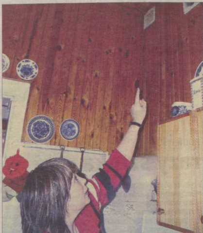
Opary lakieru przedostają się prawdopodobnie przewodem wentylacyjnym - mówi Jadwiga Szczechowiak.
