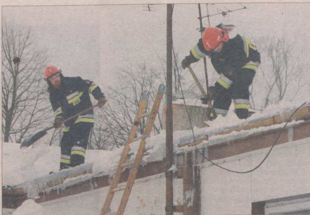
Strażacy usuwali wczoraj śnieg z dachu szkoły, aby odciążyć strop, który mógł się zawalić.
