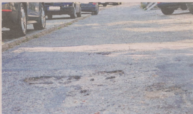
- Dziura goni dziurę - mówią kierowcy o drodze łączącej ul. Pochyłą z ul. Miłą
