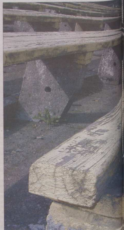
Wystające gwoździe i zdeprawowane ławki. Tak niestety wygląda obiekt przy ul. Traugutta w Gdańsku.
