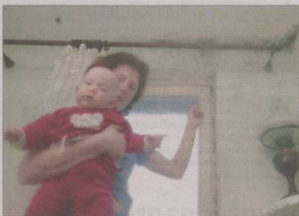
Magdalena Rosa pokazuje pleśń na ścianach mieszkania.
