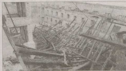
Teren byłych zakładów mięsnych to ruina, która cały czas grozi zawaleniem.
