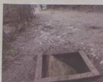
Otwarta studzienka jest niebezpieczna dla przechodniów zwłaszcza po zmroku.
