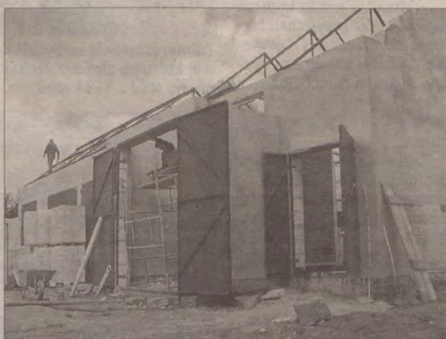
Wybudowana niedawno w Wierchowiu kotłownia na słomę doskonale spełnia swoją rolę.
