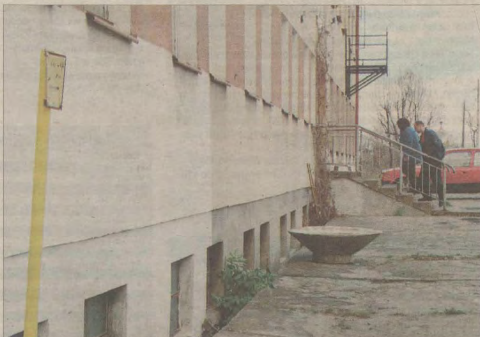
Przyłącze gazociągu przy bloku na ul. Towarowej istnieje (na zdjęciu po prawej). Mieszkańcy nie mają jednak instalacji w mieszkaniach.
