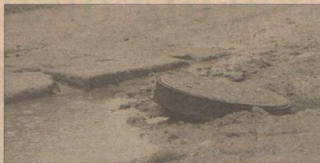
Ulica Zakładowa to dla kierowców piekło, a najlepszym przykładem jest zniszczona od kilku dni studzienka kanalizacyjna.
