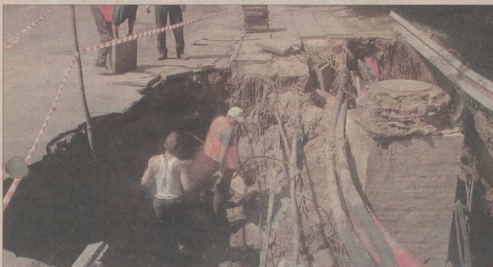
Omal nie doszło do tragedii, bo woda podmyła też słupy oświetleniowe, które mogły runąć na jezdnię.
