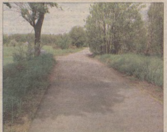
Do szczęścia brakuje tylko 200 metrów asfaltu.
