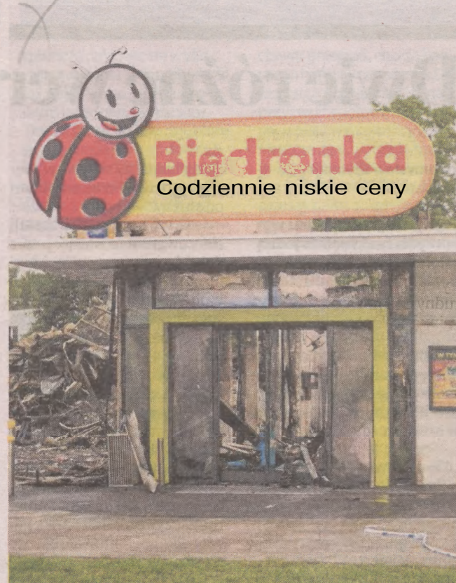
Wczoraj zostały przeprowadzone oględziny miejsca pożaru z udziałem biegłego z zakresu pożarnictwa
