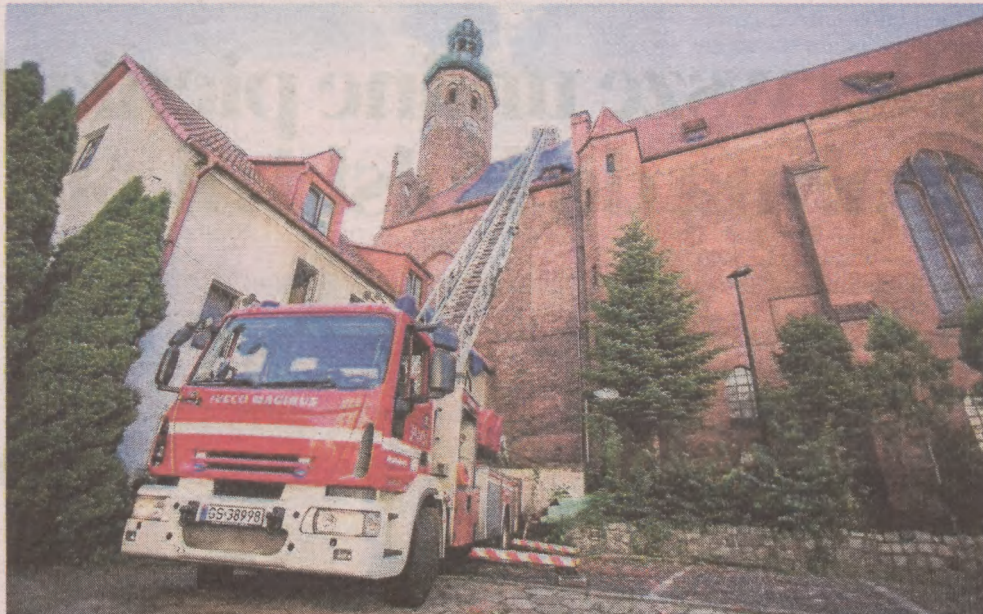
Kilka set kilogramowa metalowo-drewniana iglica z miedzianymi okuciami przysporzyła strażakom pracy na całą noc. Zabezpieczali dach za pomocą planek
