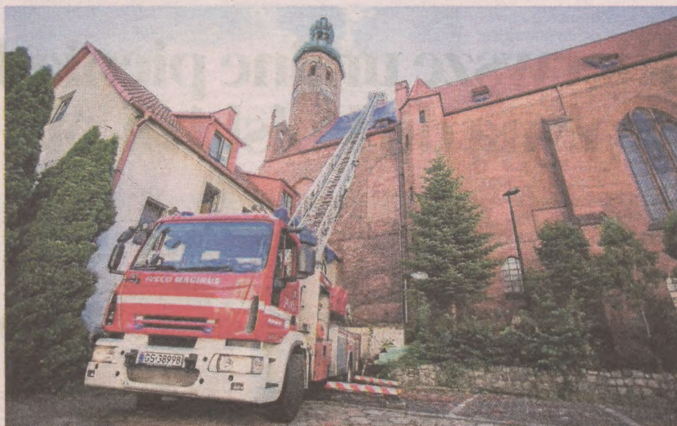
Kilkusetkilogramowa metalowo-drewniana iglica z miedzianymi okuciami przysporzyła strażakom pracy na całą noc. Zabezpieczali dach za pomocą plandek
