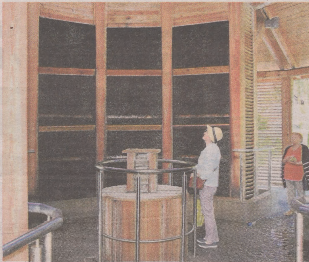
W uesteckiej tężni solankowej część tarniny jest sucha i nie działa generator aerosolu
