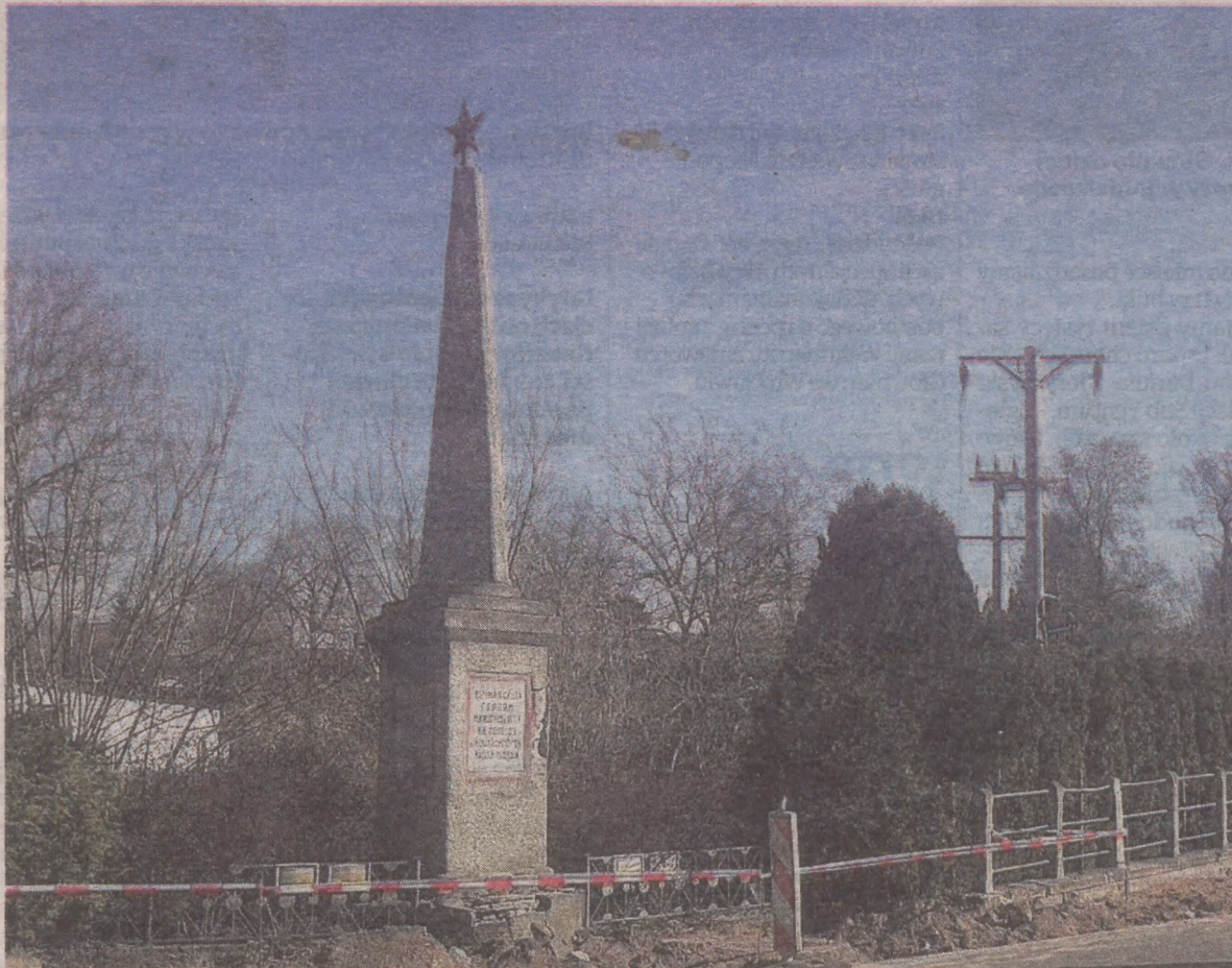
Chodnik przy pomniku zerwano. Obelisk jest przechylony
