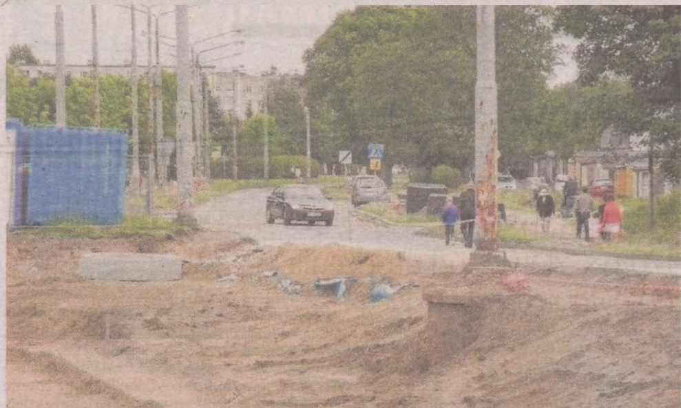
Biegły specjalista orzekł, że wzdłuż nowej drogi, wybudowanej w Słupsku za unijne pieniądze, powstała samowola budowlana
