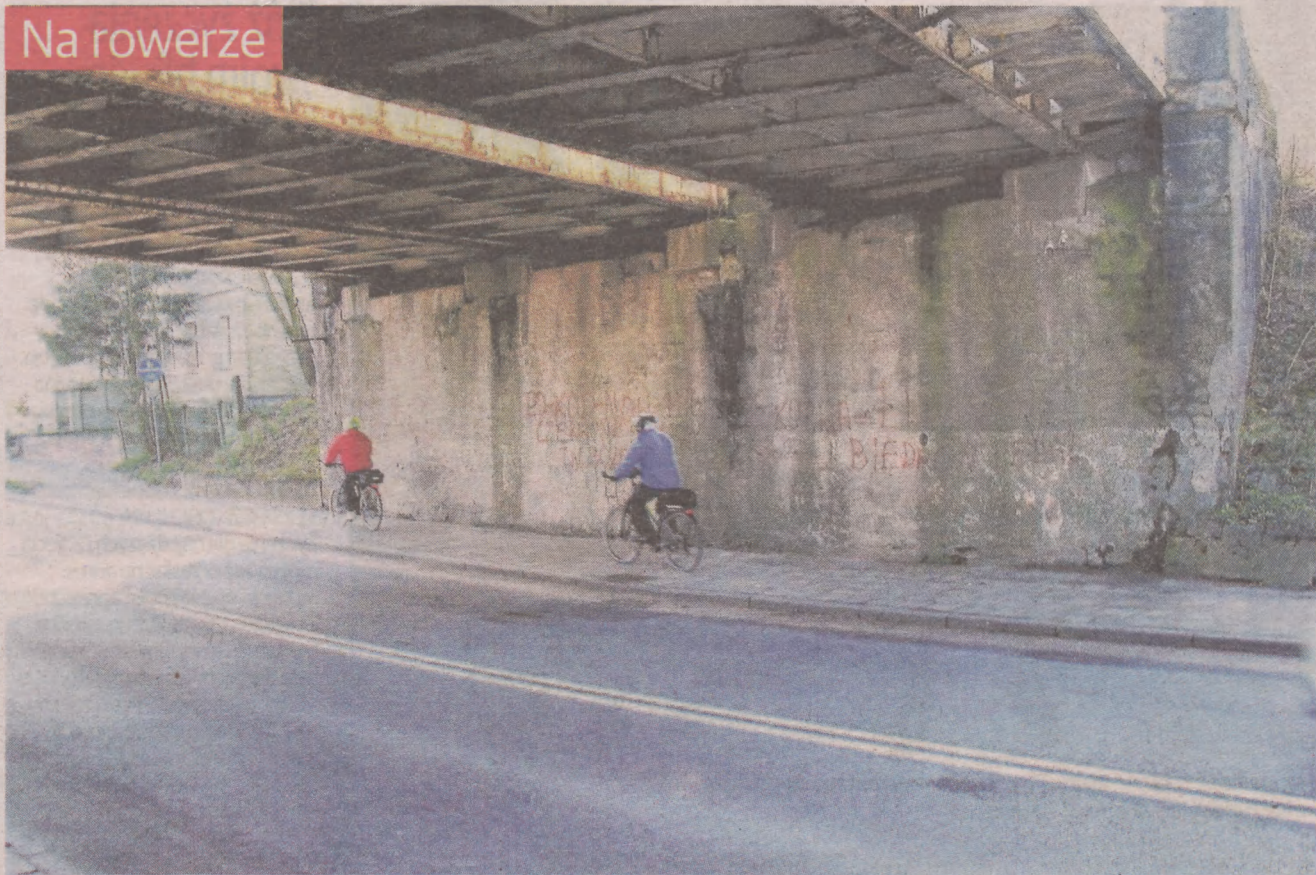
Na trasie pieszo-rowerowej Słupsk - Ustka czynny wiadukt kolejowy, który się sypie ze starości i zaniedbań
