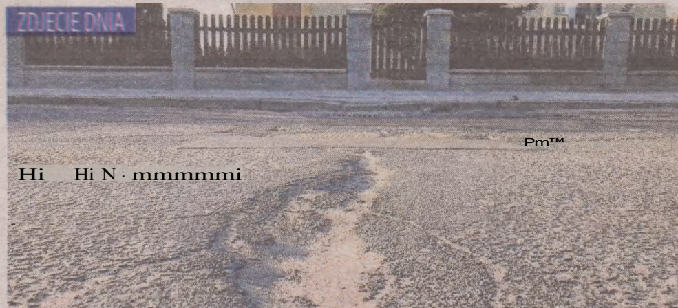
Ślupszczanie skarżą się na ubytki w jezdniach. Ci z Gdynińskiej zauważają, że drogowcy tu trafiли, ale... - Przed świętami dokonano naprawy doraźnej, natomiast w tym tygodniu dzięki poprawie pogody rozpoczęło się łatanie ubytków na gorąco masą z recyklera - informuje ZIM.
