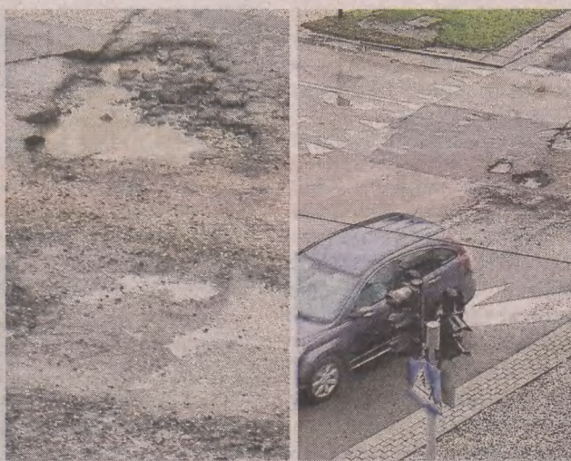
Tak wyglądały dziury na ulicy Sienkiewicza. Dzisiaj są zaklejone
