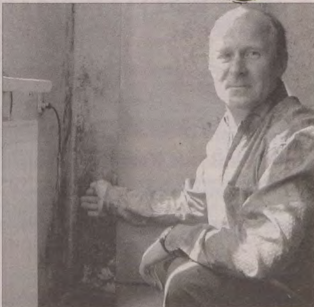
- Tu się nie da normalnie żyć - mówi Czesław Sikora, pokazując pleśń na ścianach w mieszkaniu.
