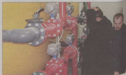
Ostatnio w Jastrzębiej Górze oddano do użytku „małą” stację uzdatniania wody.
