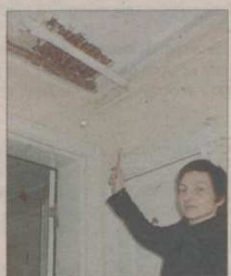
Justyna Wawrzyniak, która pracuje w Dworku Sierakowskich, nie może już pa-trzeć na odpadający tynk.
