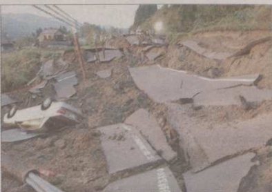
Około 300 tysięcy domów pozabawionych jest prądu elektrycznego. Uszkodzona została sieć telefoniczna oraz wodociąg i sieć gazu.
