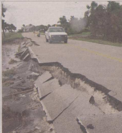
Podmyta i uszkodzona szosa w Rocky Point Road na Florydzie to dzieło huraganu Jeanne, który zaatakował Florydę w niedzielę 26 września.
