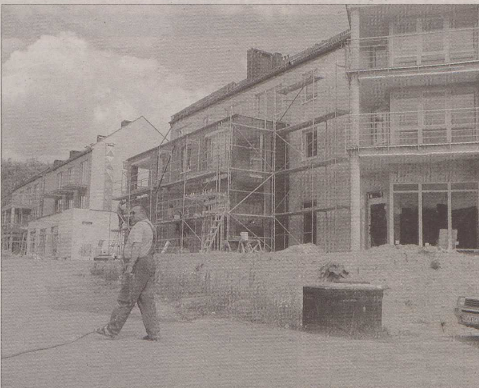
Jeśli magistrat nie wywiąże się ze zobowiązań w terminie lokatorzy domu przy ul. Kossaka będą mieszkać bez wody.
