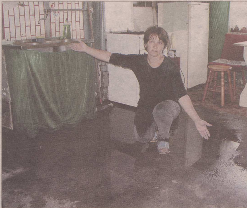
Woda stoi na podłodze kuchni. - Ze zlewu po myciu naczyń spływa przez godzinę, bo w szambie nie ma miejsca - mówi Barbara Ś.
