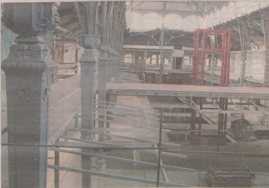
Niedokończone wnętrza Hali Targowej czekają na finał remontu. Bez dodatkowych pieniędzy nie będzie on możliwy.
