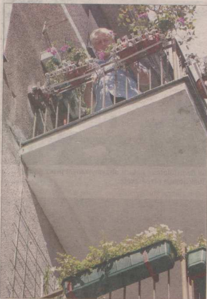
Zabytkowe balustrady zniknęły z tych balkonów 7 lat temu.
