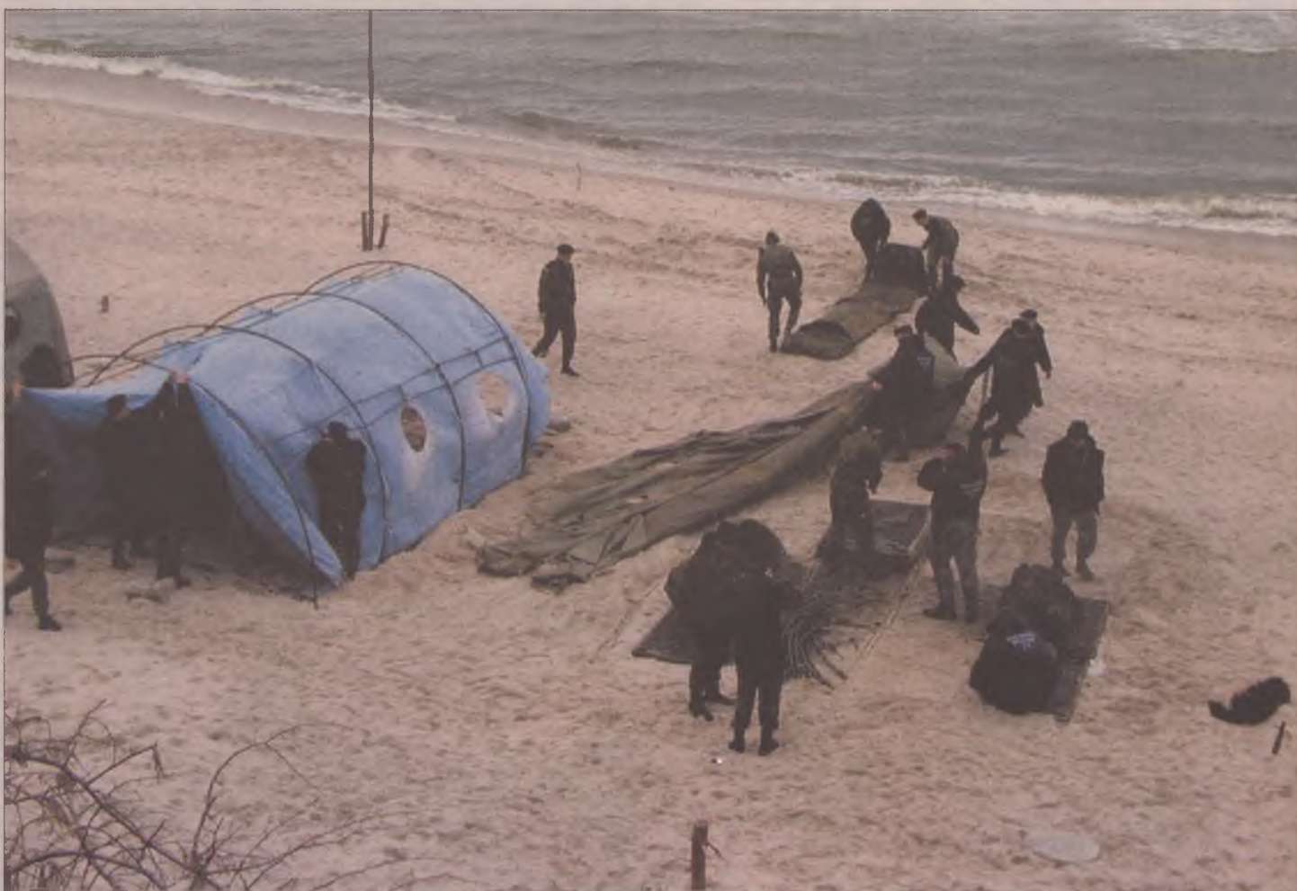
Brzeg poligonu w Wicku Morskim uratować mają wierzbowe płyty ułożone na nadmorskim klifie.
