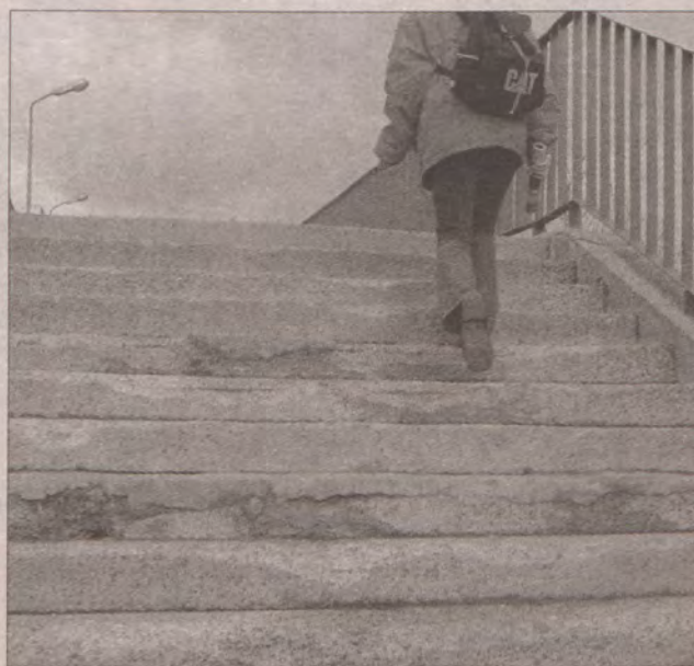
Na zdezastowane schody, prowadzące do stacji SKM w Janowie od strony ul. Sobieskiego zwrócił uwagę radny Aleksander Kubina.
