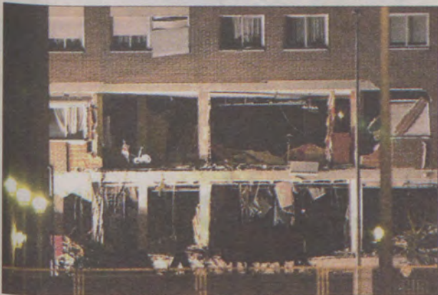
Zniszczony podczas eksplozji dom.
