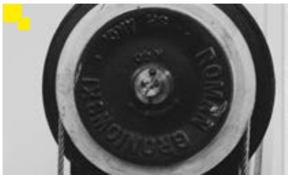
Maszynownia przedwojennej windy. Fot. Andrzej Busler
