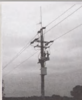
Конструкция под радиоуправляемый разъединитель 15 кв. с молниеотводом.
