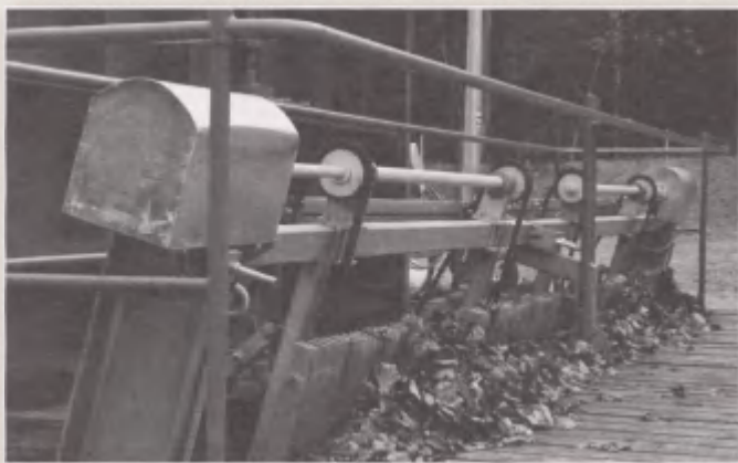
Собственного производства автоматический очиститель заградительных решеток гидроэлектростанции.
