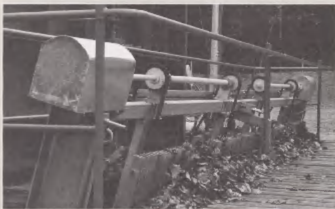
Собственного производства автоматический очиститель заградительных решеток гидроэлектростанции.
