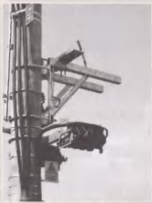
Конструкция под трансформатор и разъединитель.
