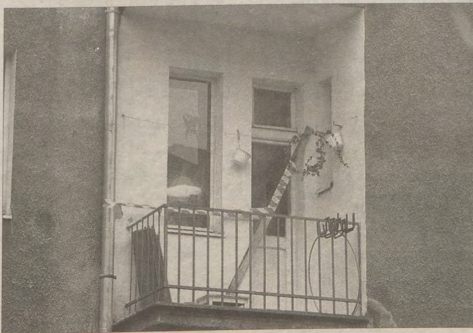
Balkon przy ul. Warszawskiej 59 został na razie zabezpieczony prowizorycznie. Na więcej nie ma zgody urzędników.
