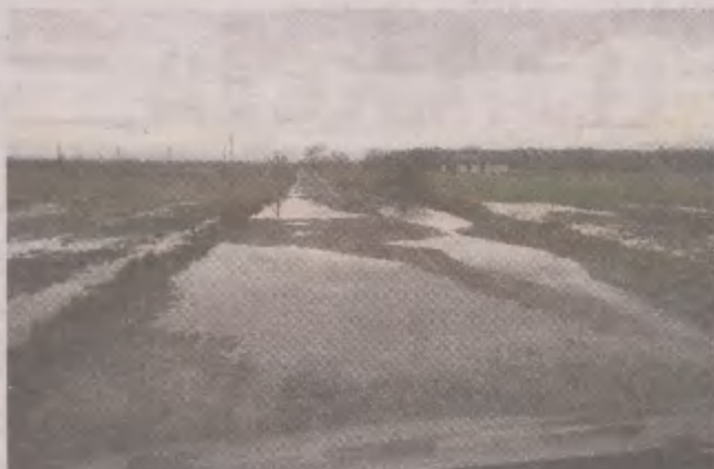
Szutrowa droga między Modlinkiem a Modłą w gm. Ustka jest nieprzejezdna. Ma być remontowana. Zobaczmy...
