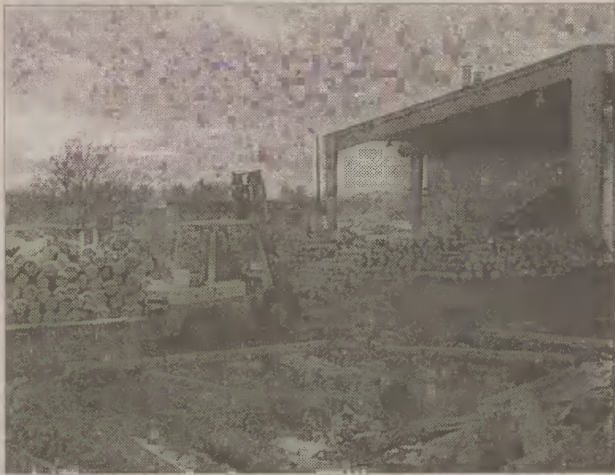
W styczniu inspektor budowlany nakazał rozbiórkę nowo wybudowanej hali. Jego nakazu do tej pory nie wykonano.
