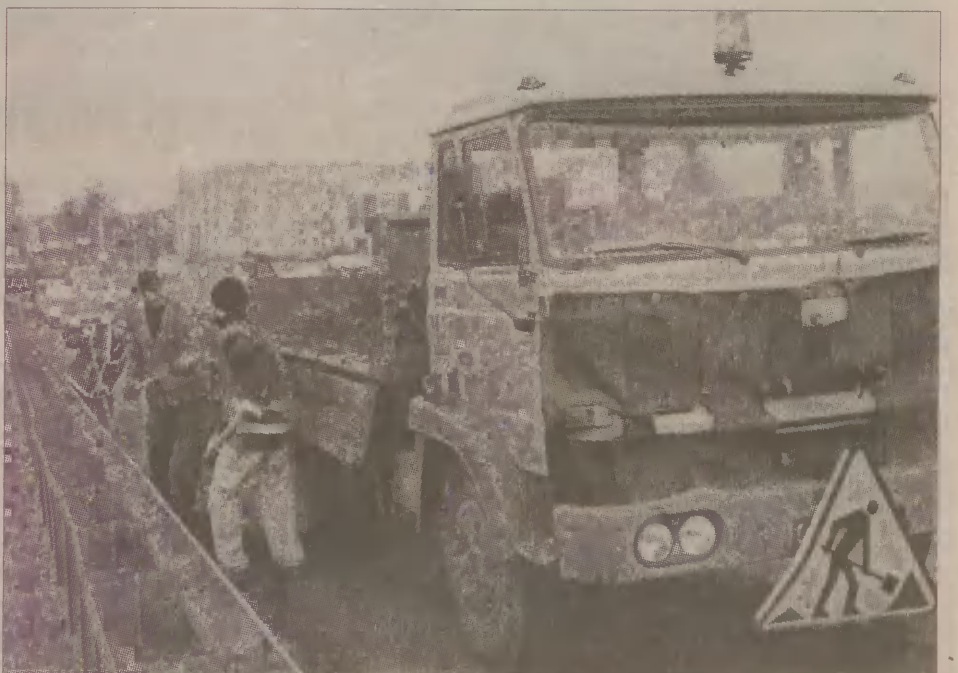
Spotkani przez nas pracownicy firmy drogowej z Trąbek Wielkich sprząтали nawierzchnię wiaduktu przy ul. Chopina.
