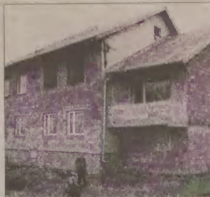
Wybuch naruszył ścianę nośną domu
