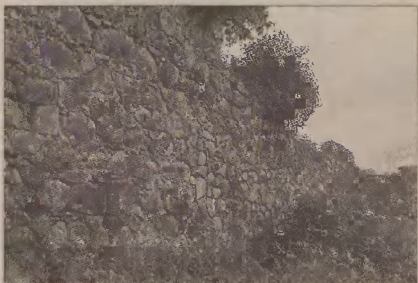
Skarszewskie mury wymagają szybkiej renowacji.
