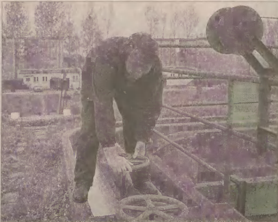
Na modernizację nowodworskiej oczyszczalni ścieków potrzeba około 950 tys. zł. Na zdjęciu: Kazimierz Wieczera.
